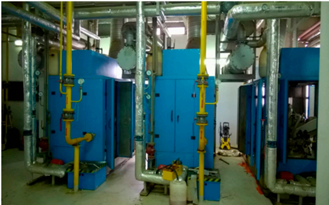
Рис. 2. Газопоршневая установка. Вид с фронта
