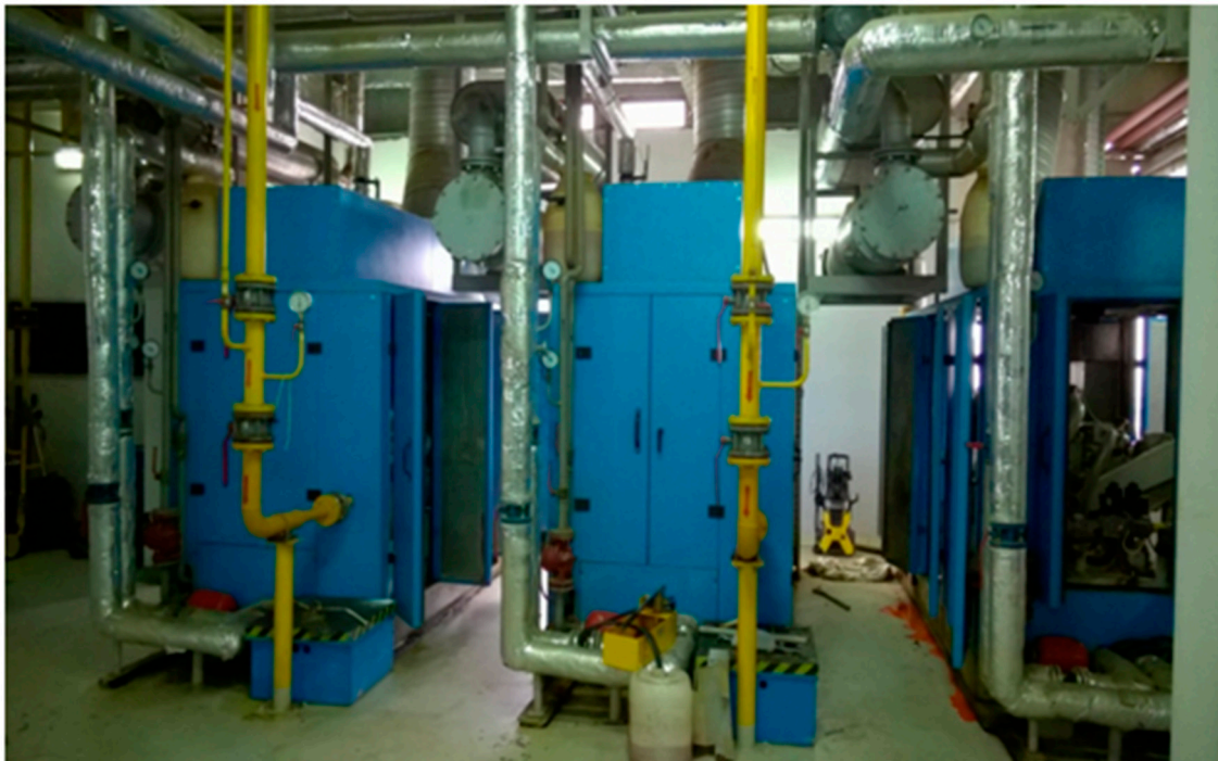
Рис. 2. Газопоршневая установка. Вид с фронта
