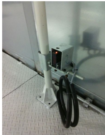
Рис. 4.а. Инфракрасный испускающий датчик №1 сушильной печи.
