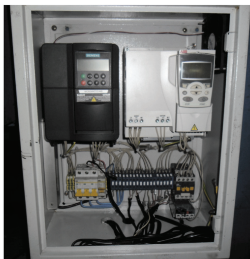
Рис. 9. Установленные преобразователи частоты
