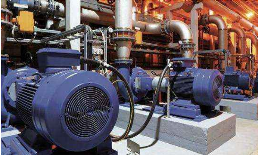
Рисунок 2. Общий вид насосов с электроприводом.
