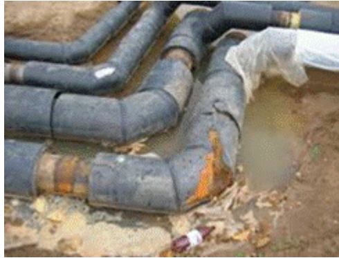
Рисунок 4 – Не соблюдение требований при монтаже труб
